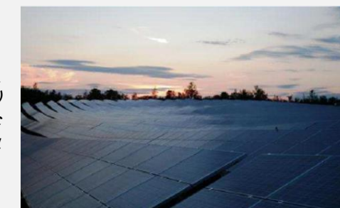
Centrale Solaire du SYCALA Département : Lot (46) Puissance électrique : 8 000kWc Mise en service : Juin 2011
